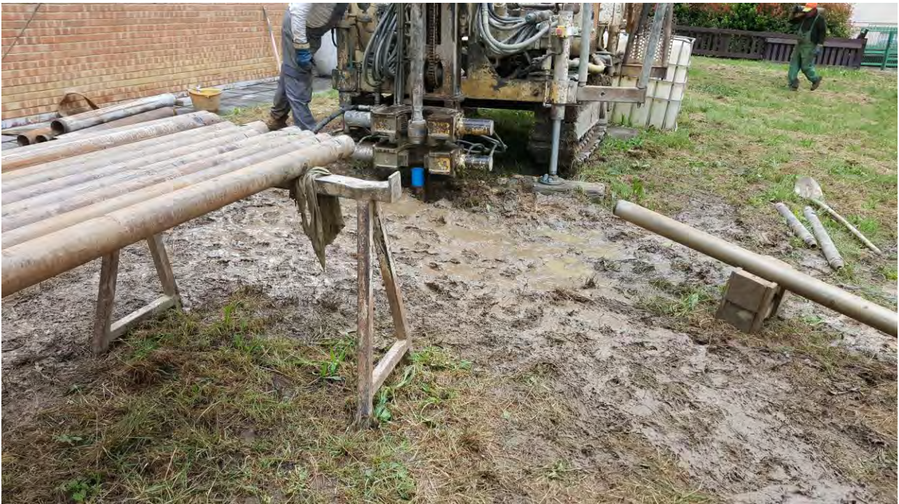
FOTO 10-11 Le foto mostrano alcuni momenti dell'installazione del tubo per l'indagine Down hole.
